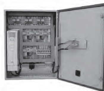
CUADRO CON VARIADOR DE FRECUENCIA
